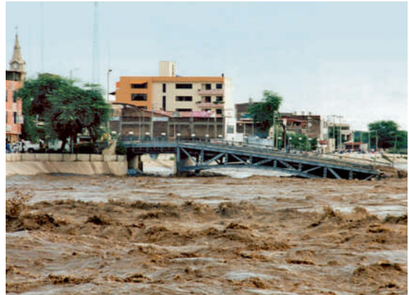
Puente colapsa en Piura tras las lluvias causadas por El Niño de 1998.
